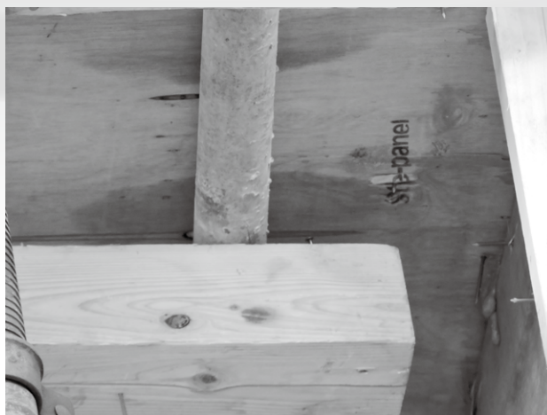
写真 東京消防庁赤羽消防署庁舎の改築工事で、コンクリート型枠用合板に熱帯合板が使用されていた
